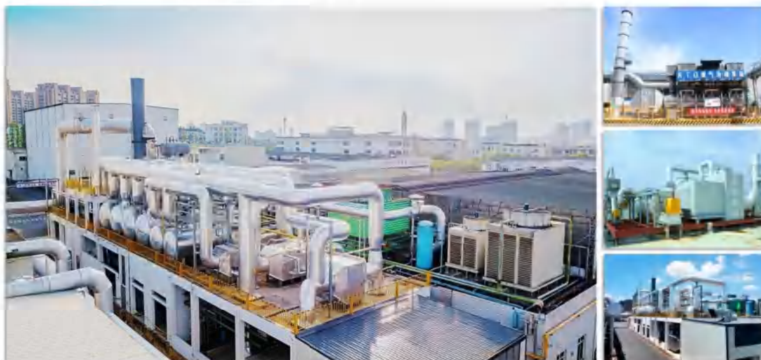
黄山永新溶剂回收废气治理项目
